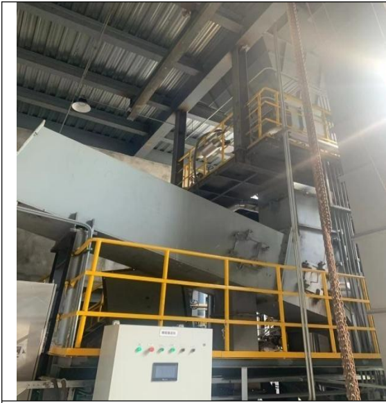
总固体废物进料口
