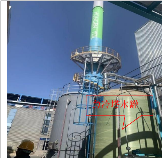
排气筒及监测平台
