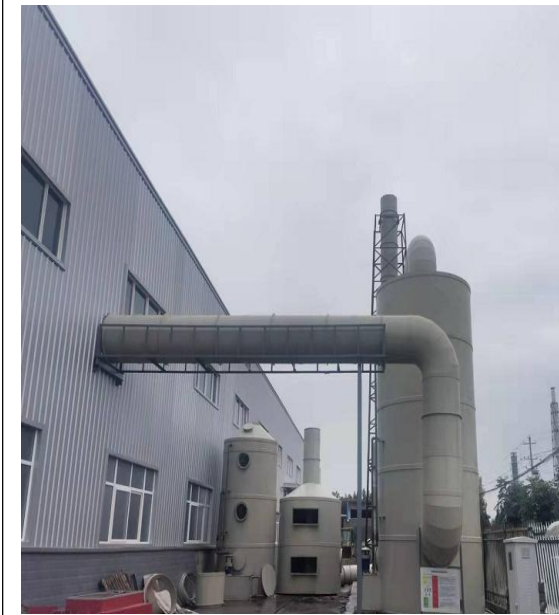
危废库房排气筒进口
