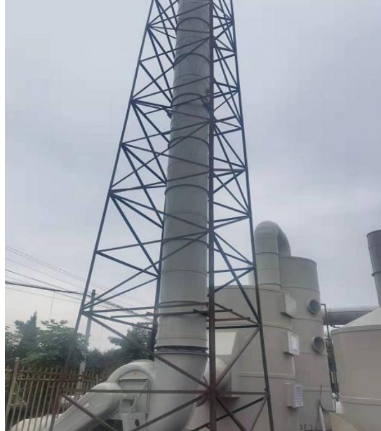
危废库房排气筒出口
