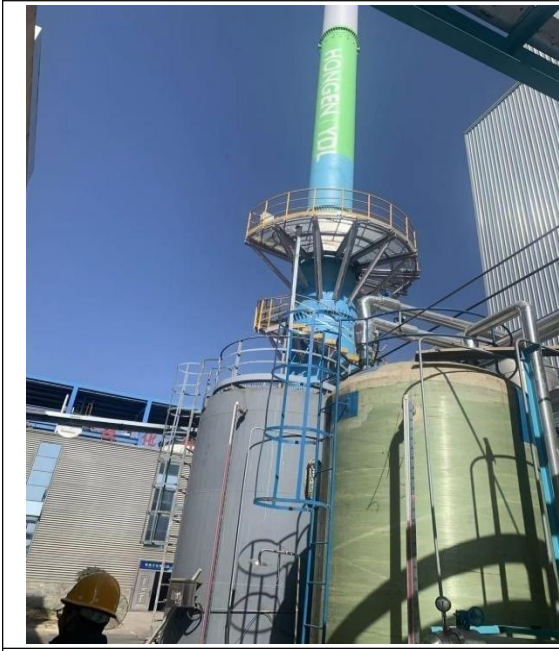
排气筒及监测平台
