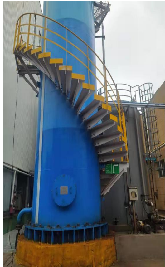
等离子炉排气筒及标识
